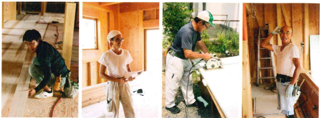
現場統括者を兼ねる大工たちは、腕だけでなく、人柄も重視する。現場を知る彼らの声家がづくりに欠かせないと考える藤田さんは、なんでも言い合える環境づくりに心を砕く。だが、「ほくが怒られることのほうが多い」と笑う。
