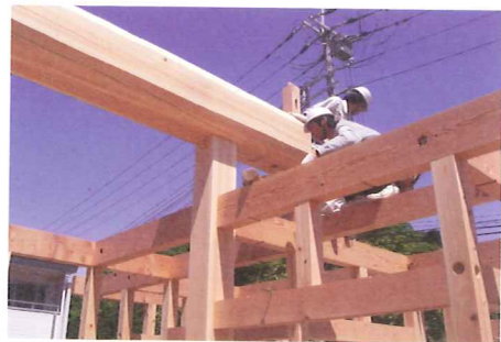
太い柱と梁を組み込んでいきます。長期自然乾燥させた8寸角東濃檜大黒柱を使用。
